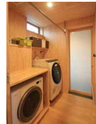
脱衣室 脱衣室には洗濯機と並んでガス乾燥機を設置した。ガス乾燥機はパワフルで乾きも早く、何よりふんわりとした仕上がりが人気となっている。
